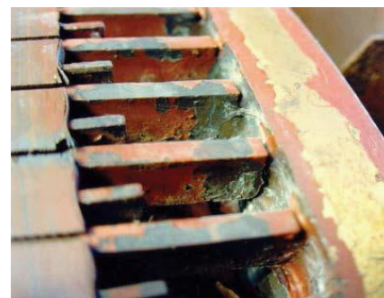
回転子バーの破損
