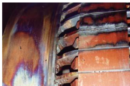
バー破損による回転子鉄心損傷
