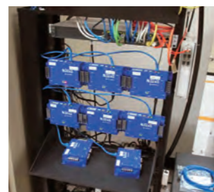
収納盤に格納されていない計測機器
