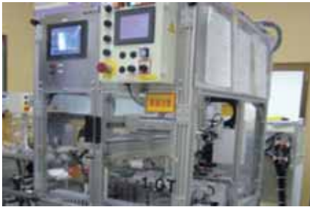
ゲル塗布・硬化装置
